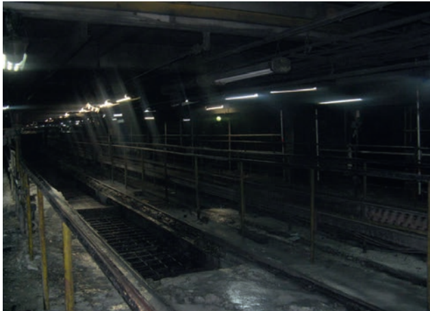
Ryc. 8. Zniszczona galeria podajników rewersowych na ciągu nawęglania
