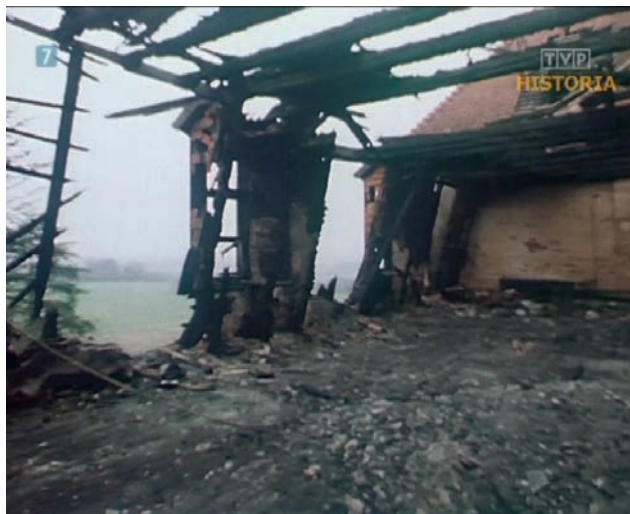
Ryc. 18. Widok zniszczeń po pożarze – poddasze Źródło: Znak zapytania , reportaż, TWF Poltel, 1980.
