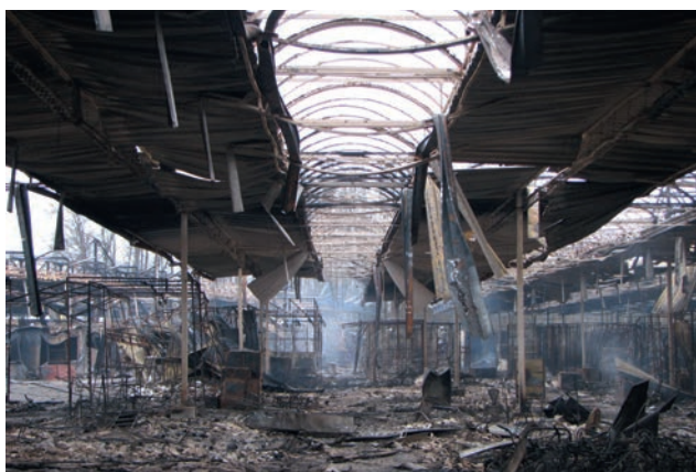
Ryc. 62. Widok zniszczonych stanowisk kupieckich
