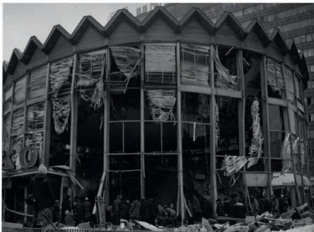
Ryc.10. Widok od zewnątrz zniszczonego budynku Rotundy PKO Źródło: Wydział ds. działalności muzealnej KM PSP m.st. Warszawy.
