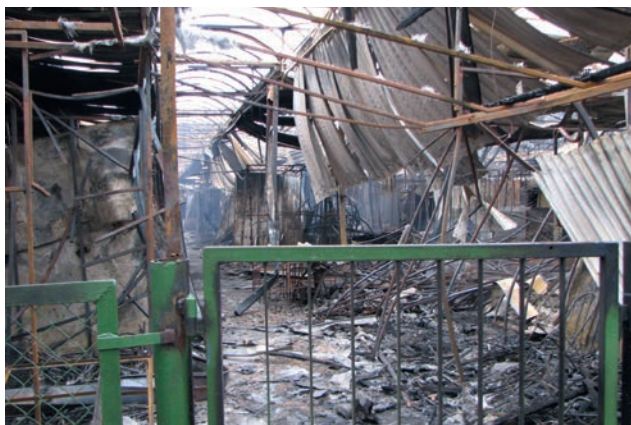
Ryc. 61. Widok zniszczonych stanowisk kupieckich
