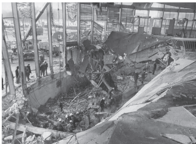
Ryc. 11. Widok zniszczeń we wnętrzu Rotundy PKO Źródło: Wydział ds. działalności muzealnej KM PSP m.st. Warszawy.
