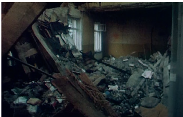
Ryc. 19. Widok pomieszczenia po zawaleniu się stropu Źródło: Znak zapytania , reportaż, TWF Poltel, 1980.
