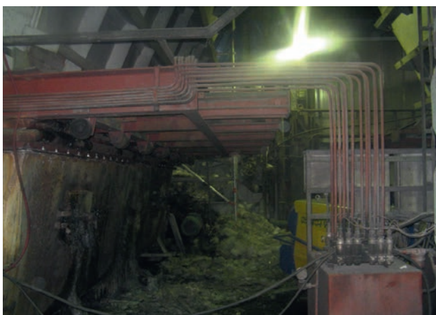
Ryc. 7. Kotłownia po wybuchu – widok od strony podajników Źródło: Zdjęcie z akt szkody udostępnione przez ubezpieczyciela.
