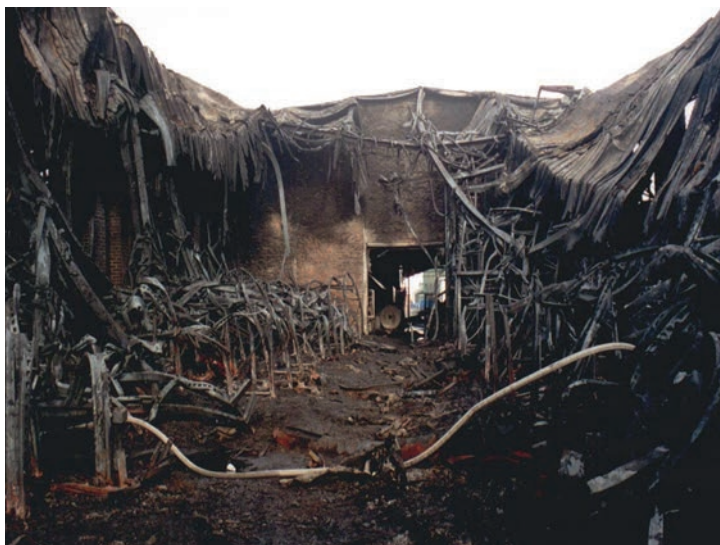
Ryc. 51. Zniszczona pożarem hala zakładu POLARCUP
